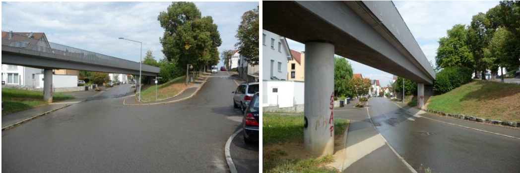
Abbildung 16: Bestandsbrücke über die Große Heerstraße. Blickrichtung Pfullingen Innenstadt. Übersicht über die Brücke (links) und Ansicht der Pfeiler (rechts).
