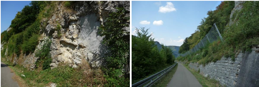
Abbildung 51: Hangsicherungen an der Honauer Steige. Ausmauerung und Spritzbetonsicherung (links), Ausmauerung und dynamische Fangzäune (rechts). Blickrichtung Unterhausen
